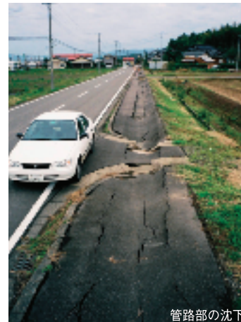
管路部の沈下
