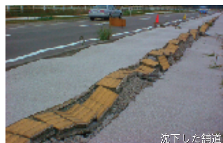
沈下した舗道
