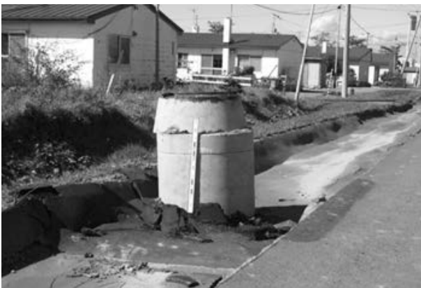
写真－3 2003年十勝沖地震における液状化によるマンホールの浮上（豊頃町）
