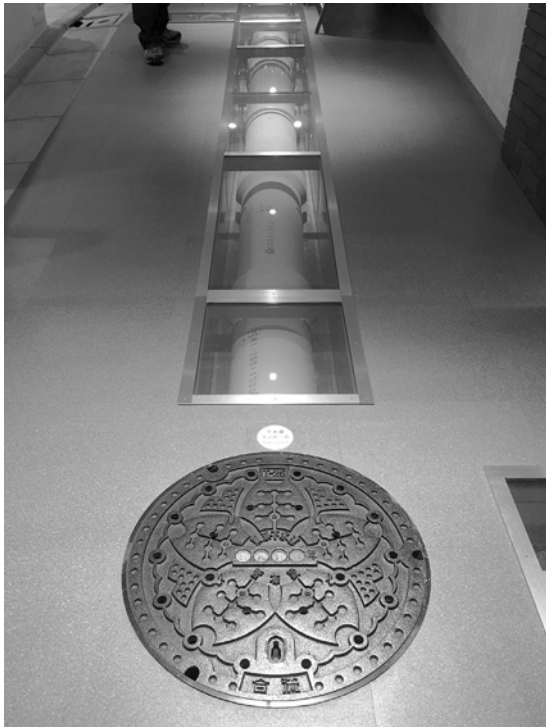
写真-4 つながっている管路が見えるマンホール蓋 展示（東京・江東区、虹の下水道館）。 蓋の周りも透明素材だとさらに嬉しい
