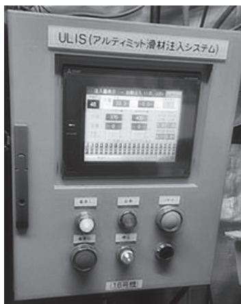
写真-3 ULIS 制御盤
