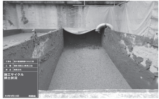
写真－14 土砂ピット
