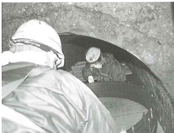
写真-1 コンクリートの腐食劣化が進み骨材が露出している
