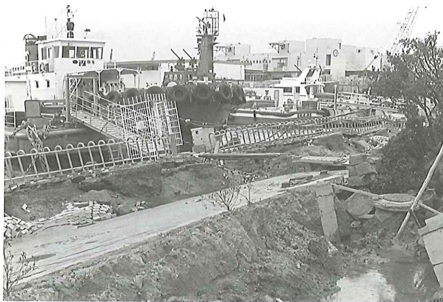
写真一 2 阪神・淡路大震災で岸壁が崩壊しマンホールがむき出しになった神戸市のポートアイランド北公園
