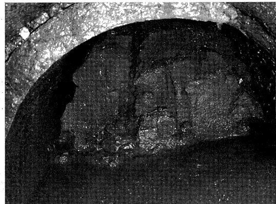
写真-4 土砂による管の閉塞状況
