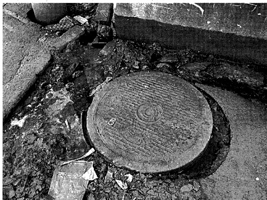
写真-2 マンホールから溢れる汚水 (平成23年9月13日撮影)
