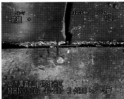
写真-6 ヒューム管の破損
