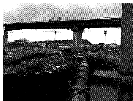
写真-7 破壊され露出した放流渠（石巻東部浄化センター）
