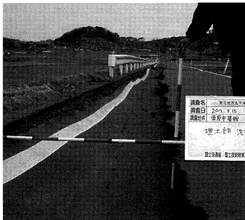
写真-3 埋戻し部の路面低下（宮城県栗原市）
