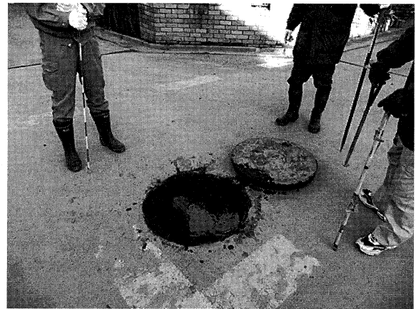
写真一 5 土砂によるマンホール閉塞 (浦安市舞浜地区)
